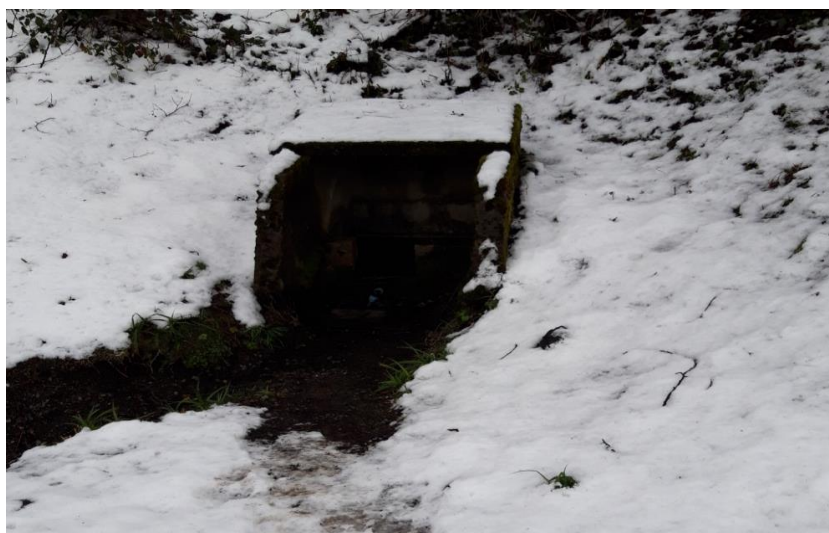
Слика 11: Каптиран извор непосредно изнад најближег стамбеног објекта
